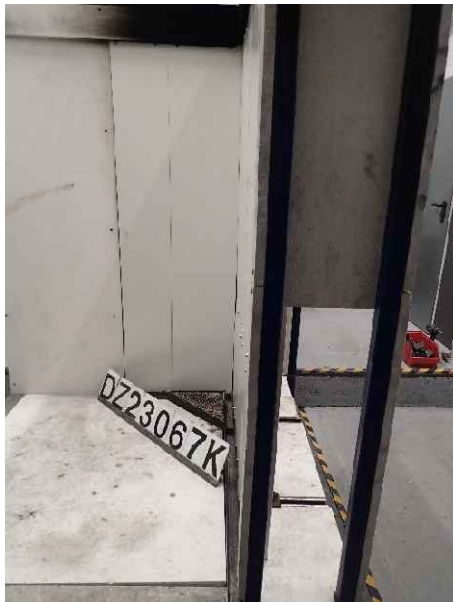
Foto 19: DZ3.1/23-067K („K-300“), Ansicht des Luftspalts des großen Flügels vor der Brandprüfung.
