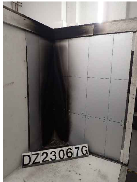
Foto 4: Prüfkörper DZ3.1/23-067G („K-300“), Ansicht nach der Prüfung.
